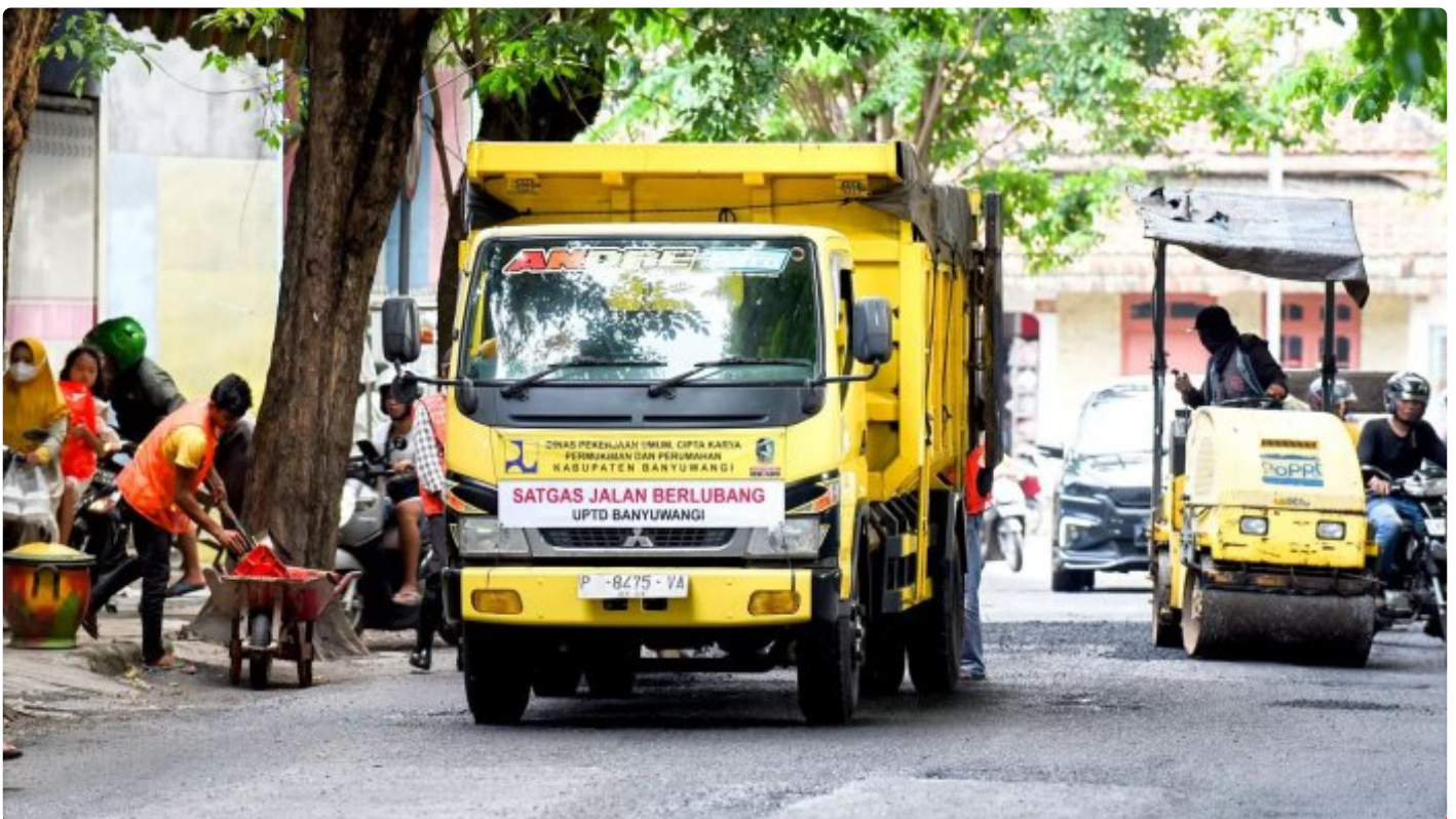
Tim Satgas Jalan Berlubang Dinas PU CKPP sedang menembel jalan berlubang di area jalan sayu wiwit menjelang Hari Raya Idul Fitri 1445 H
