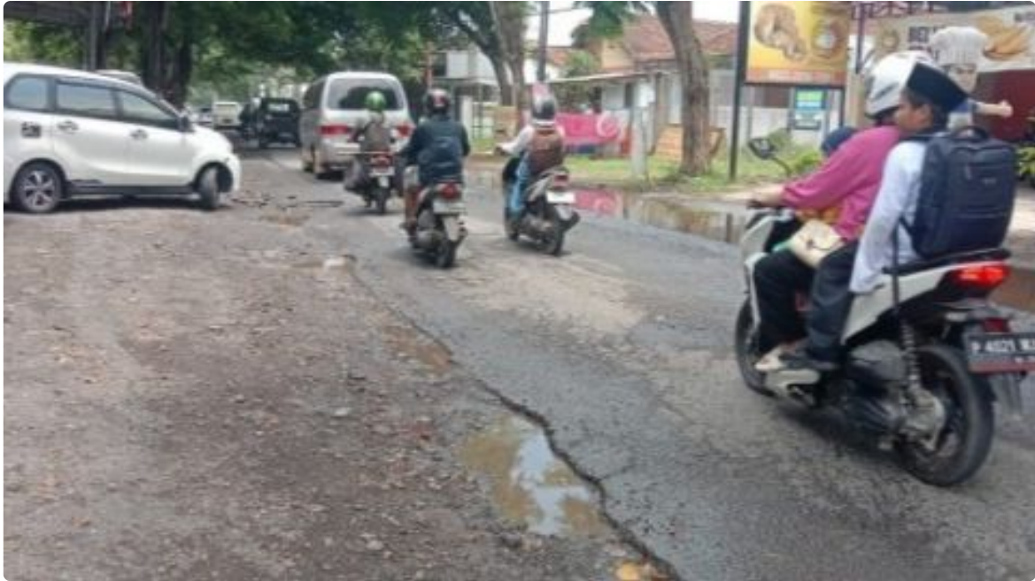
(Kondisi ruas Jalan Kepiting Kelurahan Tukangkayu, Banyuwangi)
